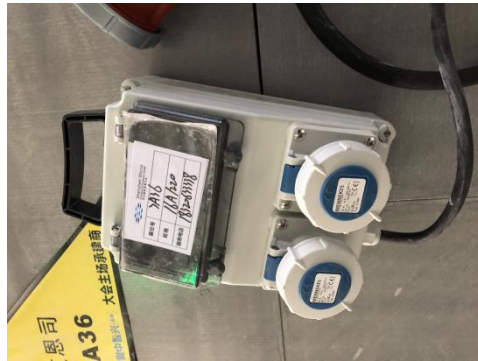
展馆一级电箱实景图二
